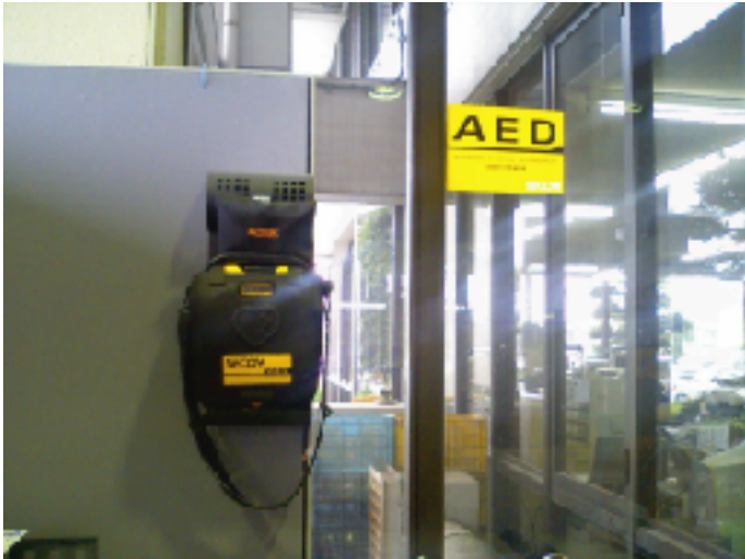
写真↑ 市役所1階 総合案内所に設置されているAED
